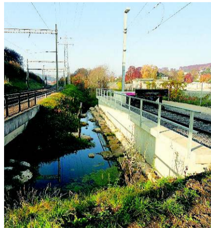
Die Rampe für das neue Auszugsgleis (r.) engt das Durchlassprofil des Süssbachs ein. H.P.W.
